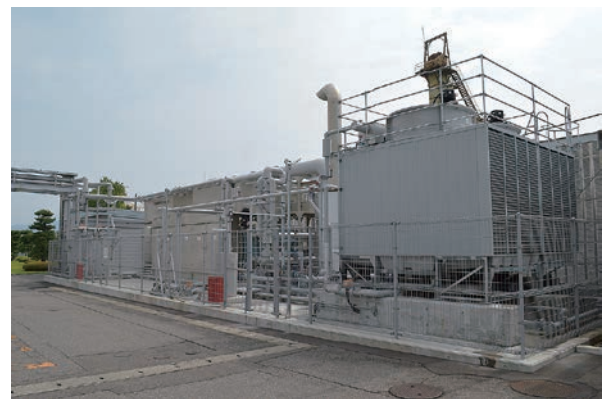
本格稼働した常用発電施設 (CGS)
