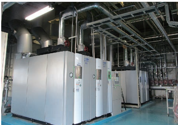
貫流ガスボイラー
