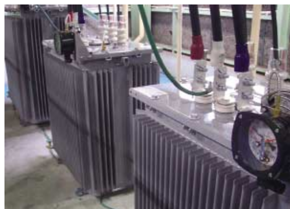
省エネ型設備：トップランナー変圧器
