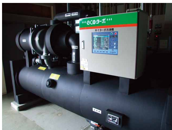
ターボ冷凍機
