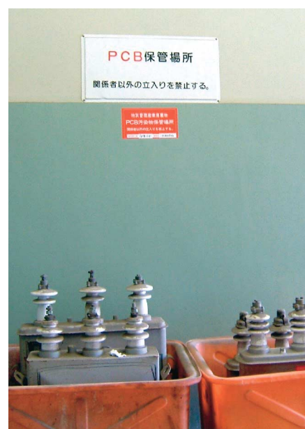
PCBの保管 (松本工場)
