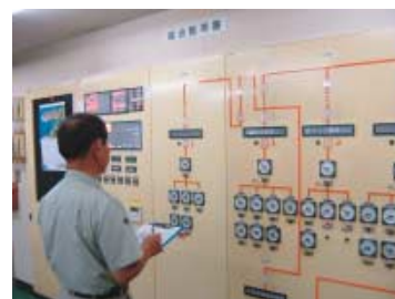
エネルギー中央監視室
